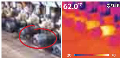
Механическая проверка электромоторов с использованием тепловизора FLIR серии E
